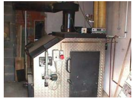
Holzvergaser mit 120 Kw Leistung
